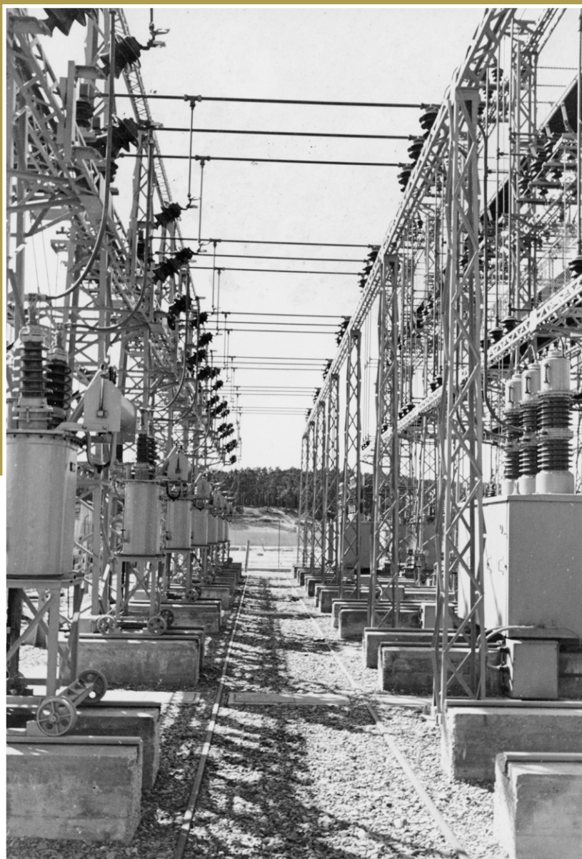
Fragment elektrowni w Stalowej Woli (131-N-347-2).
